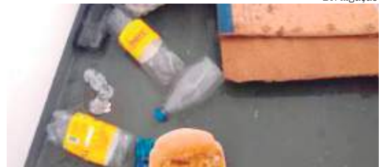
Lixo é encontrado em telhado do pronto-socorro João Lúcio, na Zona Leste
