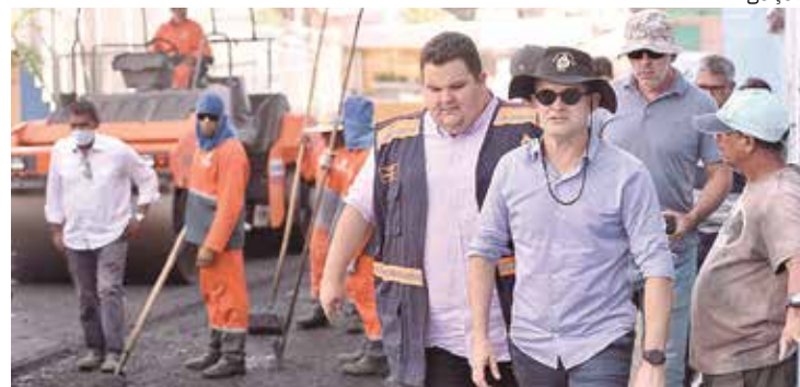
Infraestrutura chega a ruas com mais de 20 anos sem reparos
