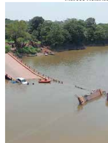
Trecho onde uma ponte caiu sobre o Rio Autaz Mirim foi liberado
