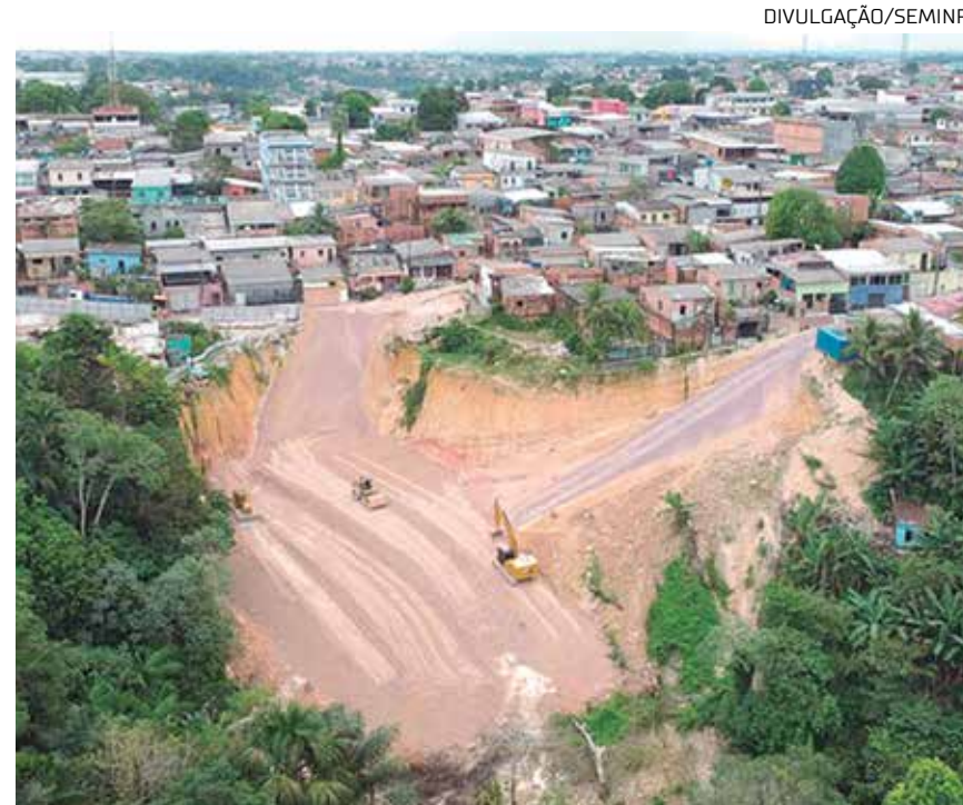
Desbarrancamento no local abriu cratera de 30 metros.
