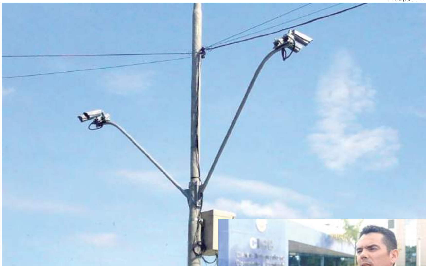
Sistema de monitoramento, o Paredão, em um poste
