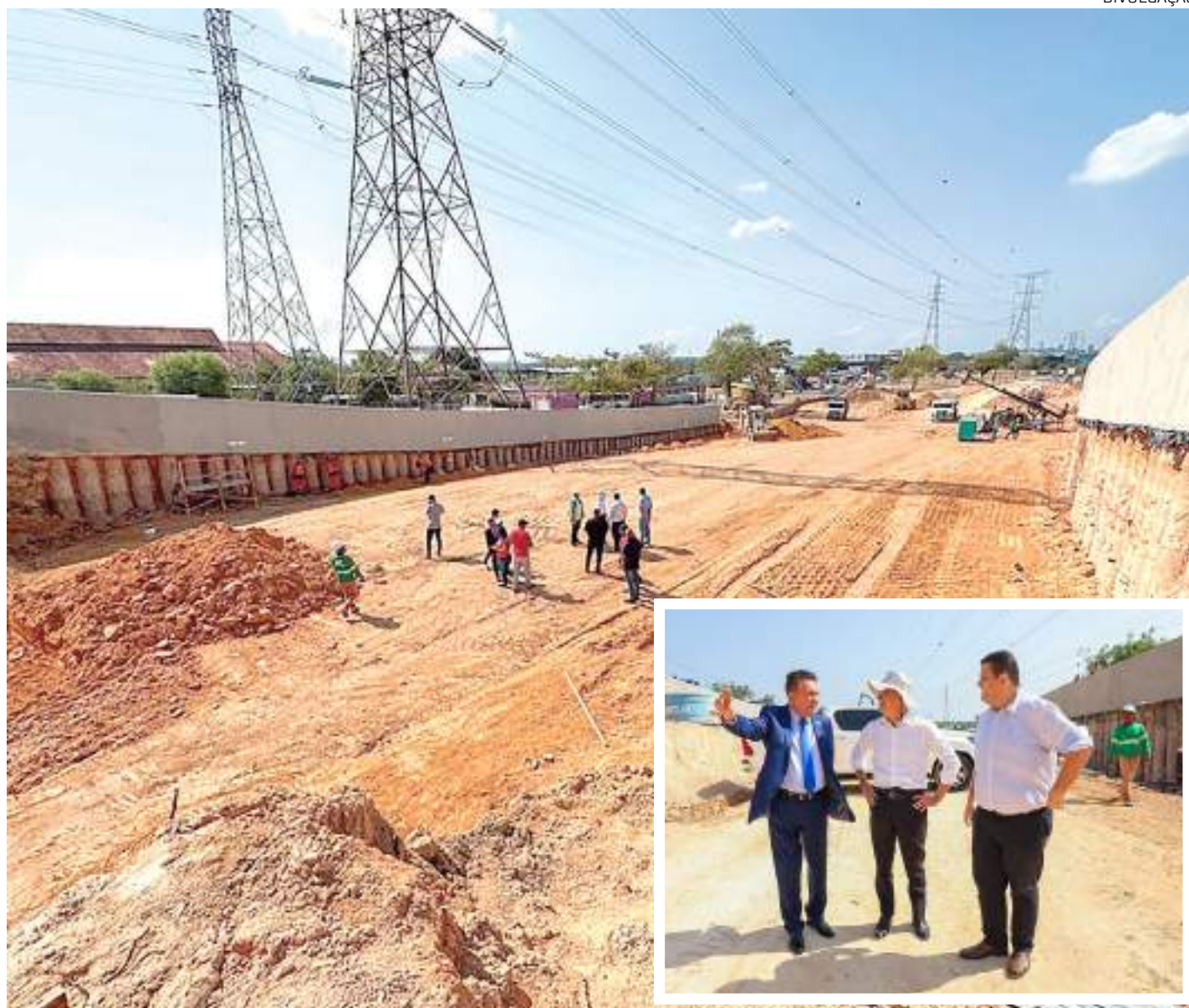
Prefeito vistoriou a obra acompanhado dos secretários municipais de Infraestrutura, Renato Júnior, e de Limpeza Urbana, Sabá Reis
