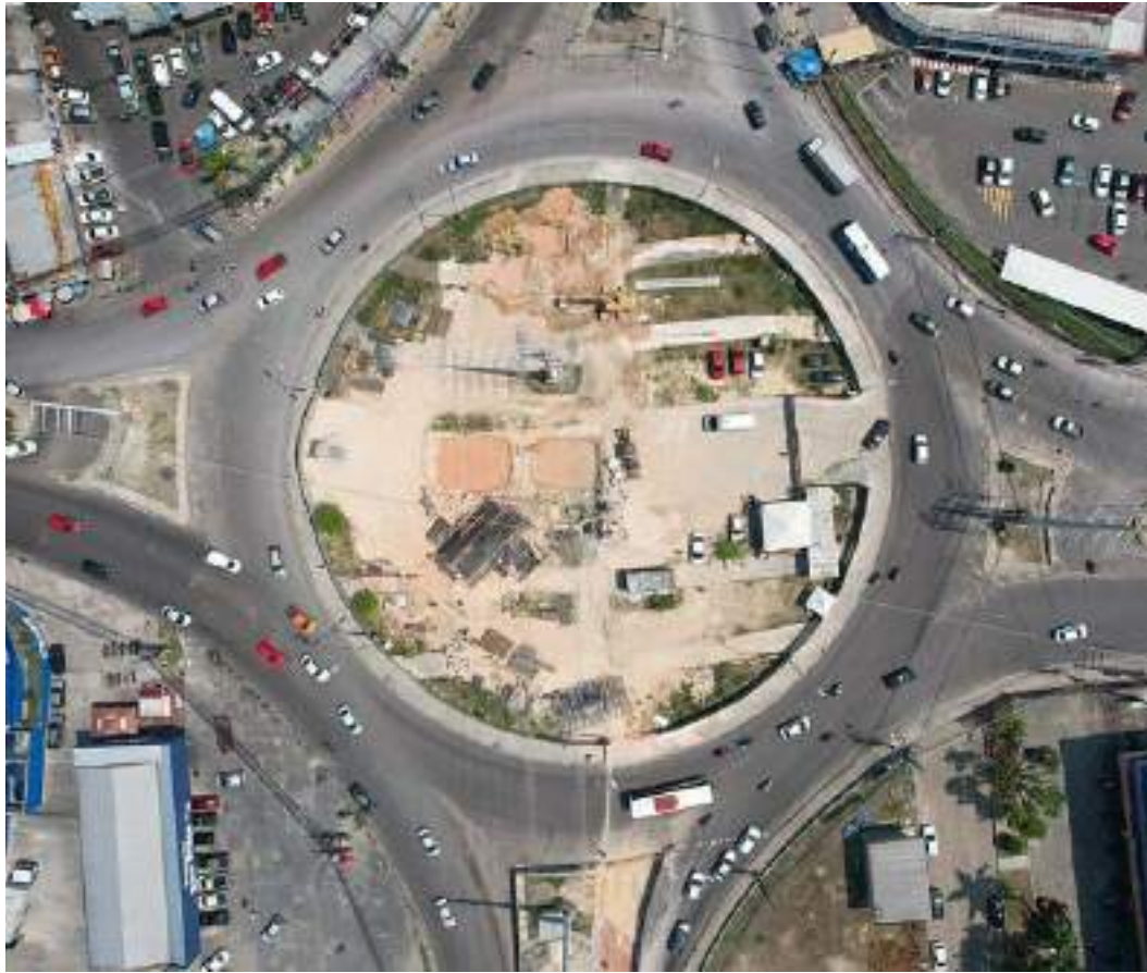
Complexo viário Rei Pelé ganha forma com 54 estacas perfuradas e concretadas na zona Leste
