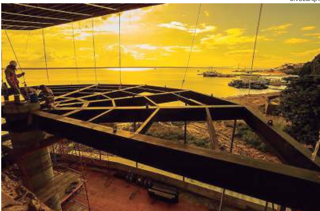
Operários trabalhando na obra do Mirante Lúcia Almeida, do programa 'Nosso Centro'
