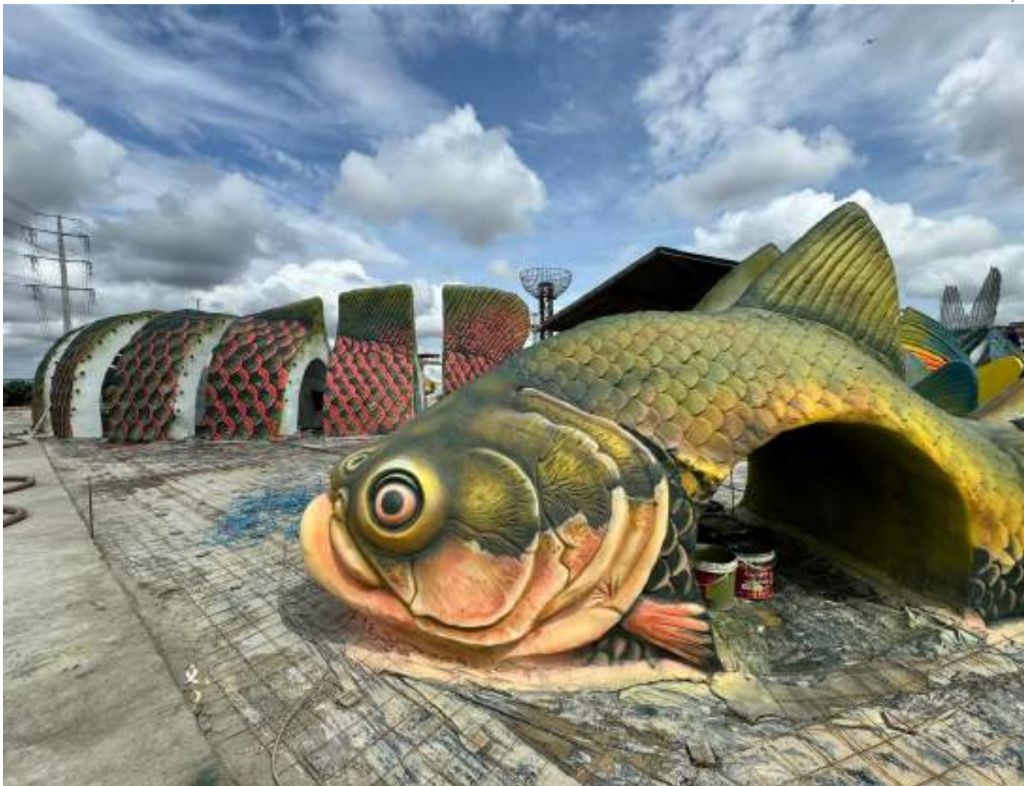
Artistas trabalham nas armações de concreto, determinando os detalhes das esculturas, com suas escamas, curvas e características das espécies
