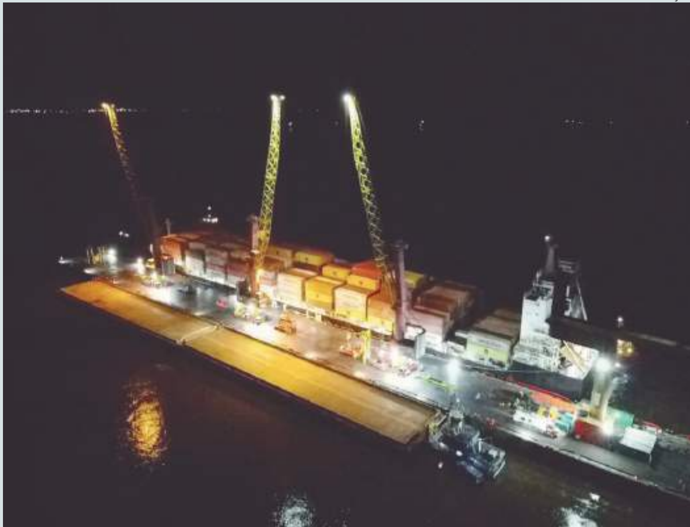
Píer foi projetado para operar em áreas de baixa profundidade, permitindo o transporte de mercadorias mesmo com a redução dos níveis dos rios
