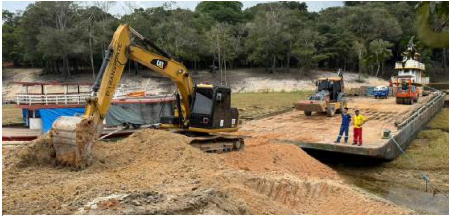
Maquinários estão sendo transportados por meio de balsas para comunidade do Livramento
