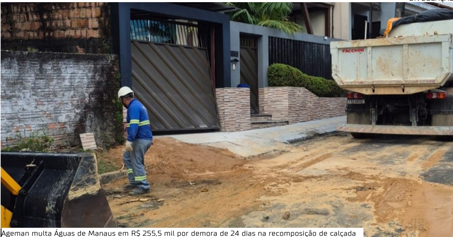
Ageman multa Águas de Manaus em R$ 255,5 mil por demora de 24 dias na recomposição de calçada
