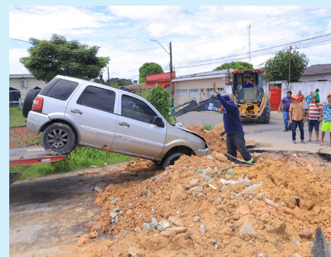
Carro cai em buraco após invadir obra em via pública
