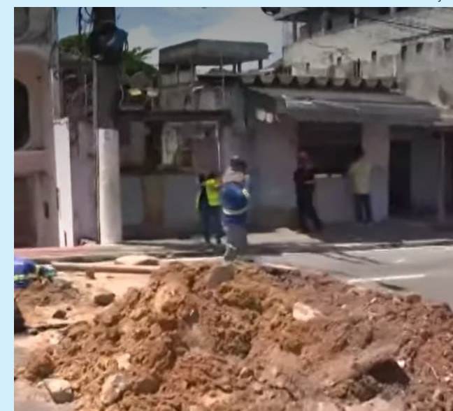
Faixa é interditada após asfalto ceder na avenida Constantino Nery
