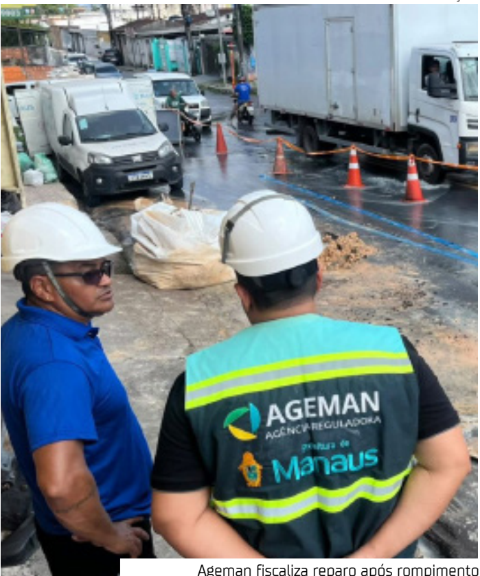
Ageman fiscaliza reparo após rompimento
