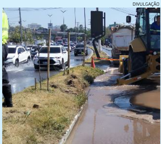
Rompimento interrompe o abastecimento e interdita faixa
